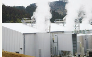
焼酎廃液発酵乾燥プラント、出ている水蒸気は発酵熱によるものです
