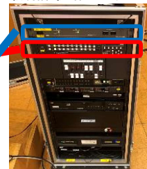
機器収納ラック
